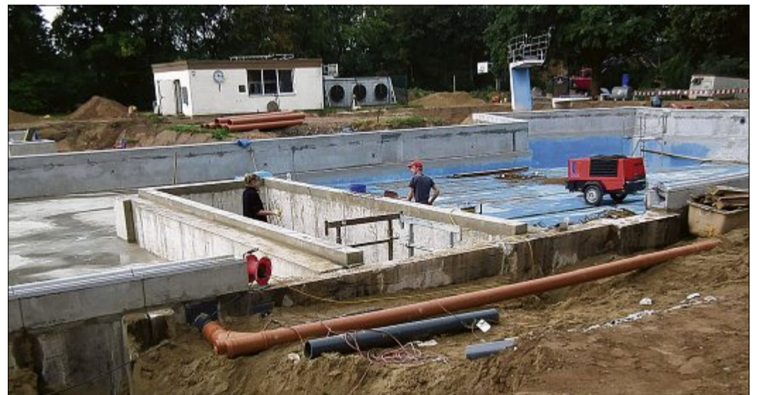
Die Bauarbeiten im Lahder Freibad liegen im Zeitplan. Der neue Steg ist betoniert und der Beckenrand kann aufgebaut werden. In den nächsten Wochen wird die neue Filtertechnik installiert und die Folie in das Schwimmbecken eingebaut. MT-Foto: Uwe Vinke
